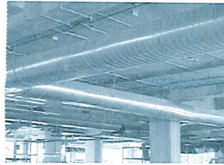
งานระบบที่ Service level อีกมุมหนึ่ง
