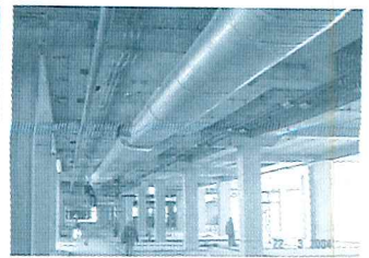
งานระบบที่ Service level Concourse G
