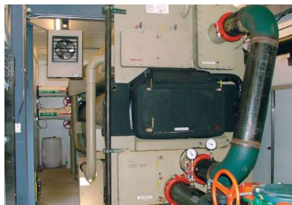
รูปที่ 2 แสดงเครื่องทำน้ำเย็นแบบดูดซึมที่โรงจักรผลิตไฟฟ้าและความร้อนร่วมที่ GTI
