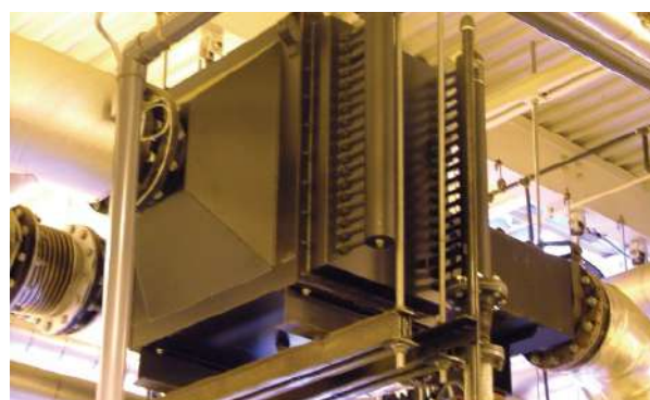
รูปที่ 3 แสดงเครื่องแลกเปลี่ยนความร้อนที่ใช้กับความร้อนที่ดึงมาจากไอเสียที่ GTI
