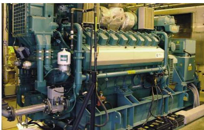
รูปแสดงเครื่องกำเนิดไฟฟ้าขนาด 1 MW
