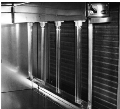
รูปที่ 4 รูปการติดตั้งระบบยูวีแนวตั้ง
