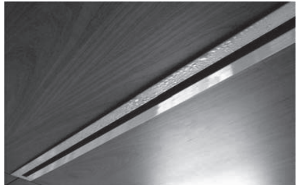
รูปที่ 7: แสดงน้ำหยดที่หัวจ่ายลมเย็นเนื่องจากมีลมรั่วผ่านแฟรมกระจกเข้ามาในห้อง
