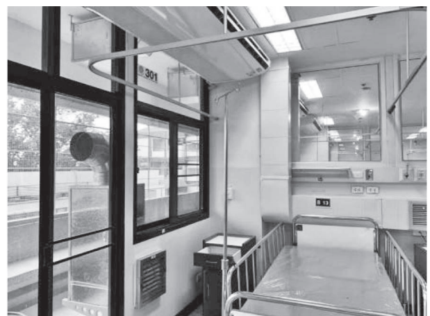
รูปที่ 4 การจัดวางตำแหน่งติดตั้งช่องหน้าการระบายอากาศในห้องผู้ป่วยแบบ Cohort Ward และการติดตั้งเครื่องกรองประสิทธิภาพสูง (HEPA filter)
